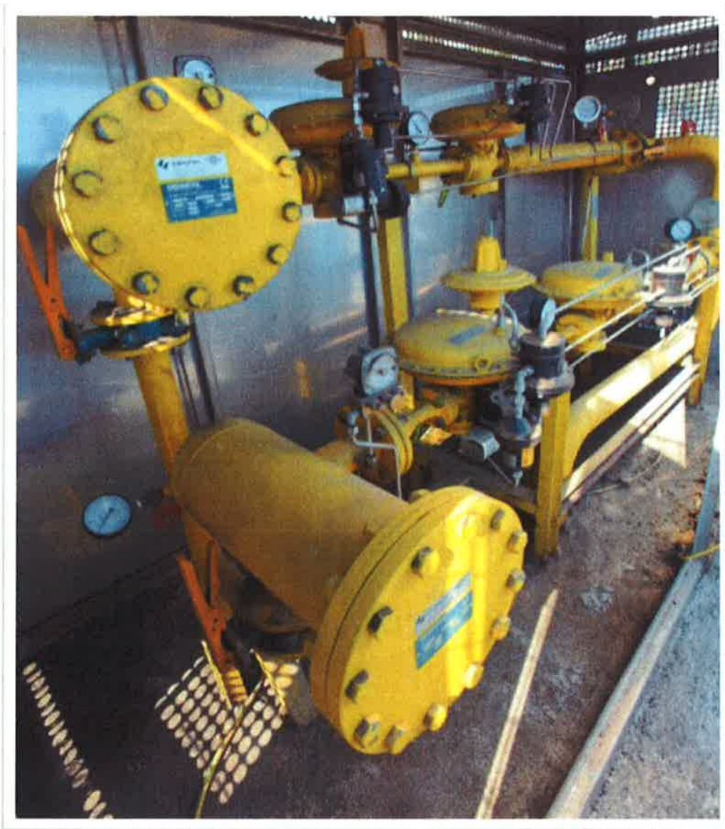
Giarre – Cabina di Decompressione
